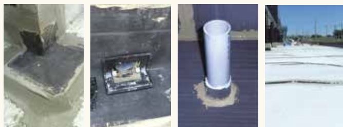
出入隅 ドレン 貫通配管 ひび割れ部増張り
