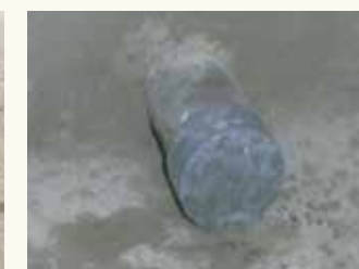
立上り配管が床に近い
