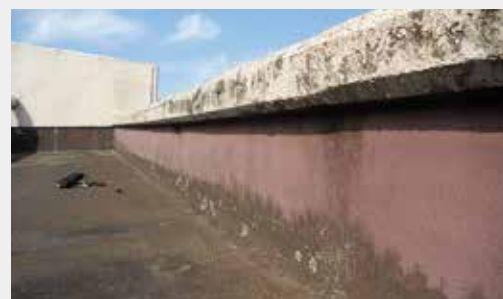
30年経過しても剥がれず、接着強度は不変！
